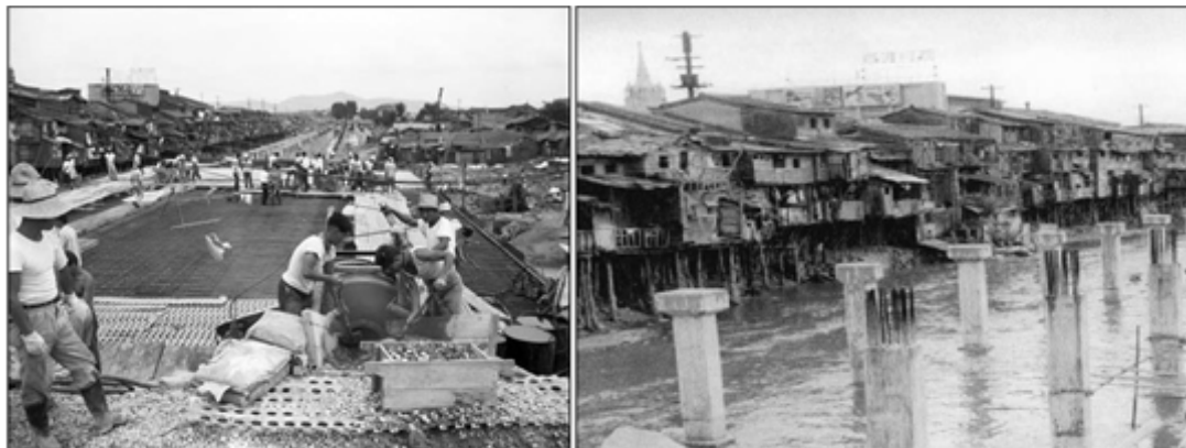
Imagem 14 e 15: Início das construções da autoestrada no centro de Seul. Fonte: Google Imagens.
